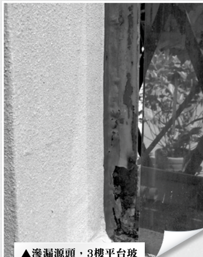
▲滲漏源頭，3樓平台玻璃及鐵架
